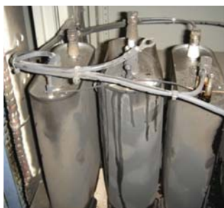
电信机房现场已被烧毁的电容器
